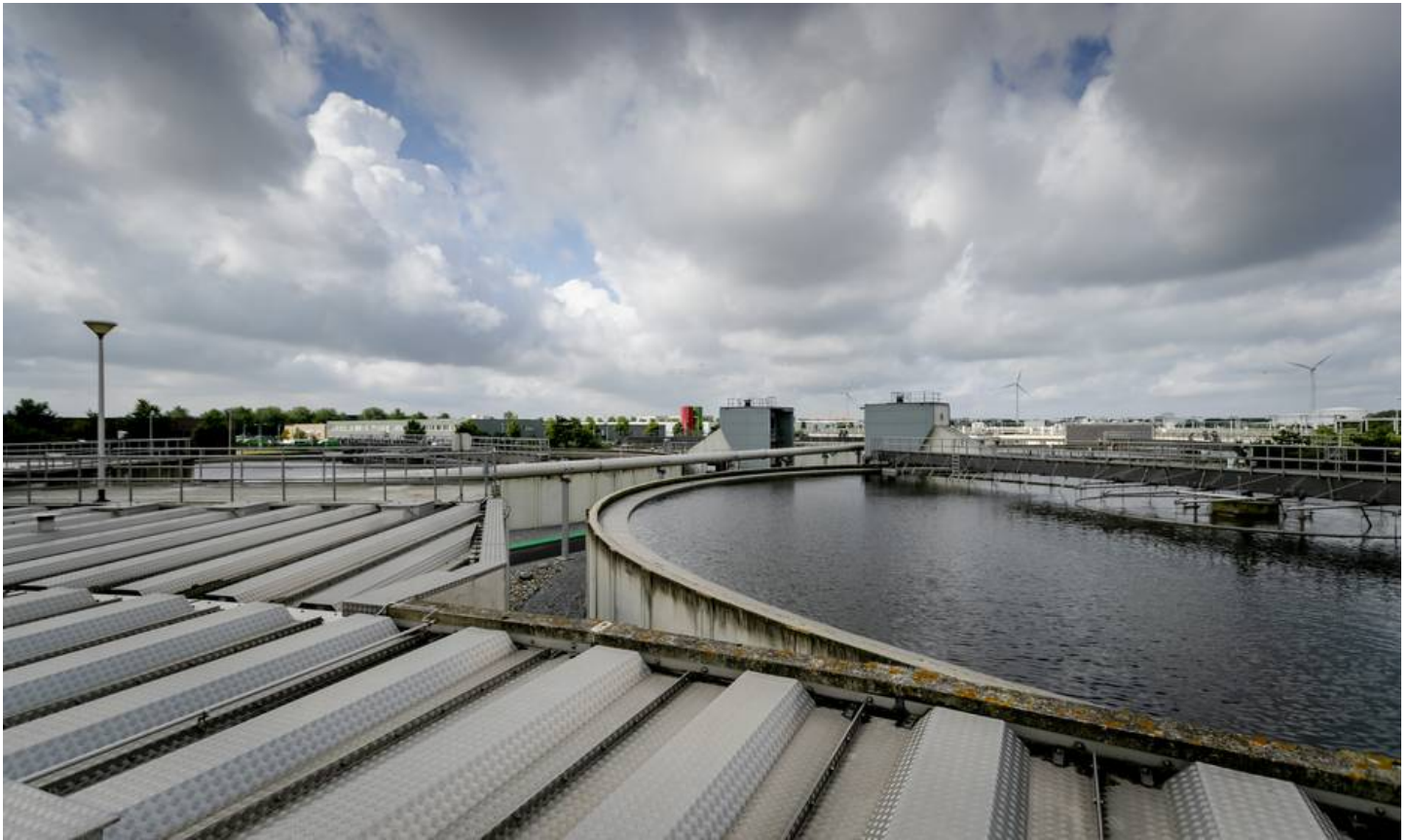
Rioolwaterzuiveringsinstallatie van waterschap Amstel, Gooi en Vecht. ©ANP / ANP
