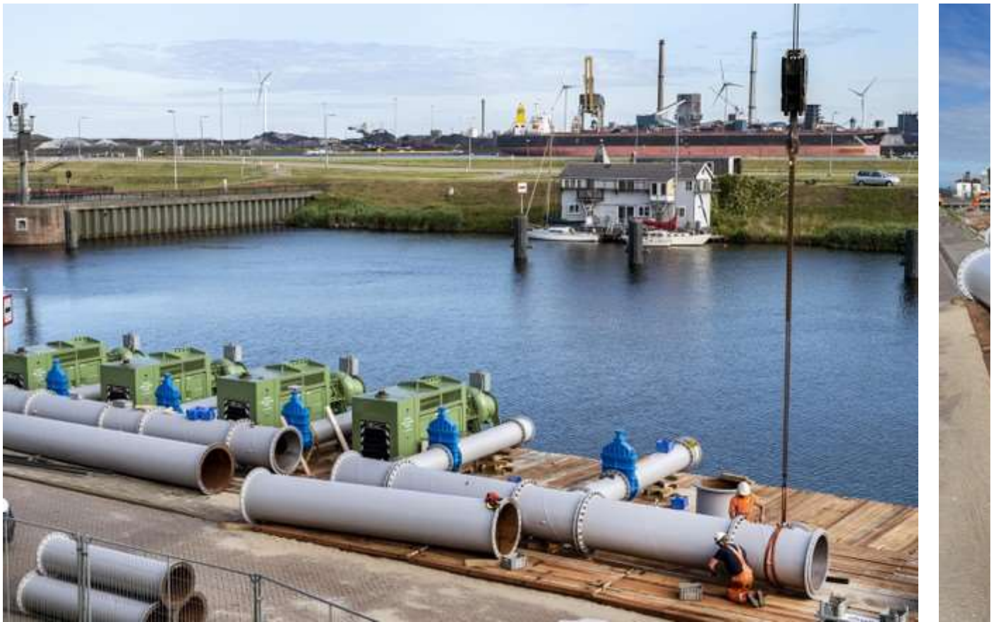
De noodpompen in IJmuiden.
