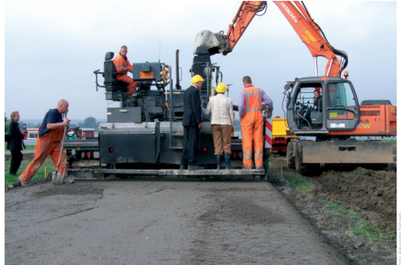
In het recreatiegebied Rhederlaag werd in 2007 een parkeerterrein aangelegd. Voor het verharde wegdek werd beton gebruikt. Bijzonder was dat dit beton gemaakt was van baggerspecie. Een wereldprimeur!
