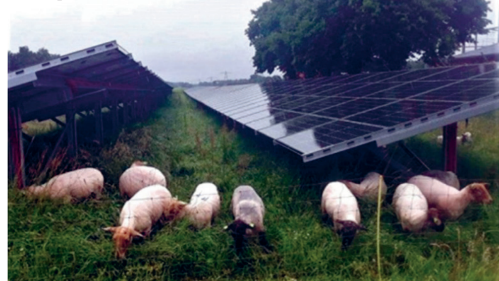
Zonnepark Entersestraat in Goor
